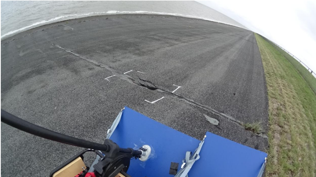
Figuur 21 – Scheurvorming in Dijkvak III
